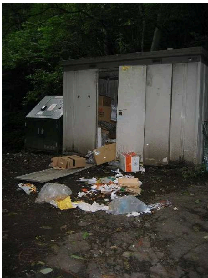
扉を破壊された物置タイプのゴミ集積所
