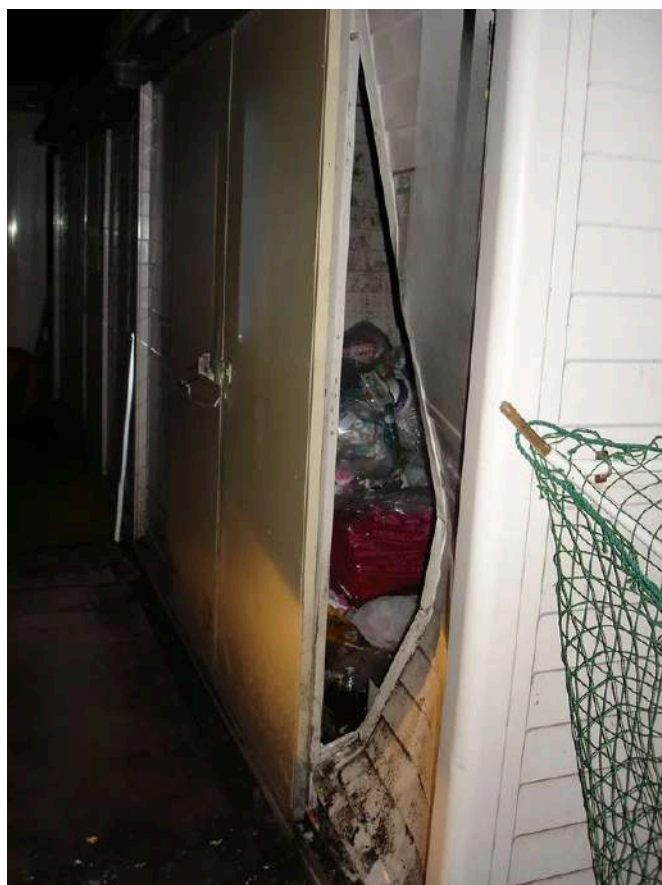
被害対策のため扉とレールを強化したものの、壁側が破壊された物置
